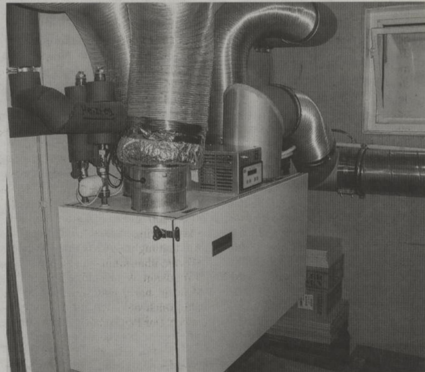
Haustechnik: Die Lüftungsanlage im Keller benötigt nur wenig Platz. Wie auf dem Bild maximal 1,50 x 1,50 x 0,50 m.
